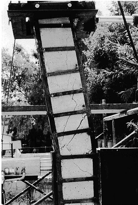
Figura 6. Agrietamiento típico en la falla
