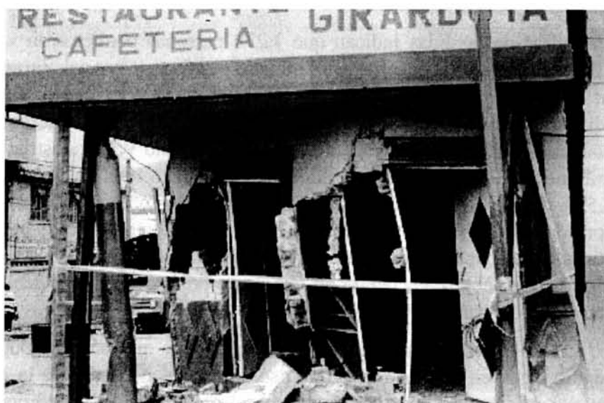
Foto 3 Edificación de mampostería no reforzada gravemente afectada (Cardona)
