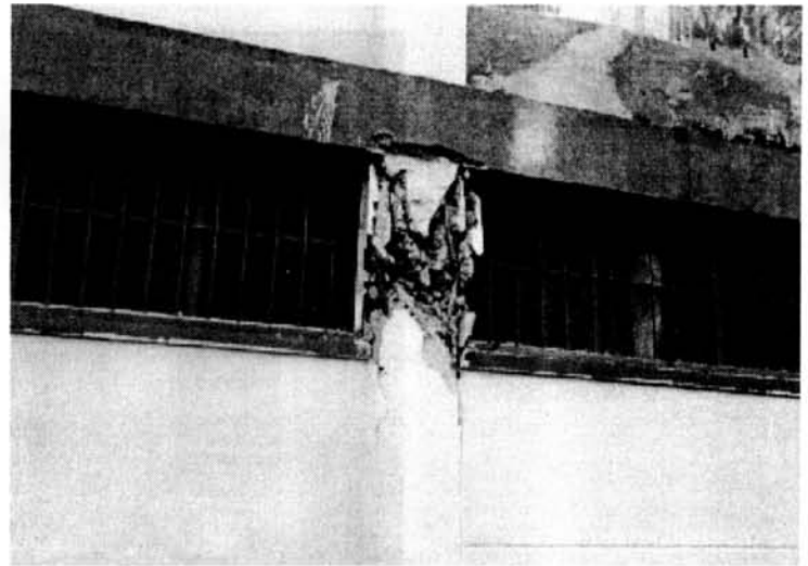
Foto 14 Efecto de columna corta por interacción adversa de muros de mampostería (Cardona)
