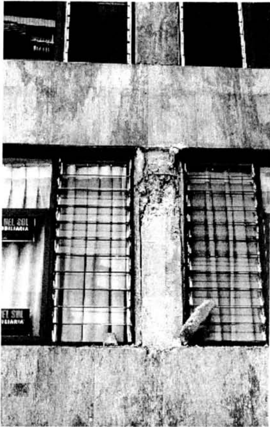
Foto 13 Daño en columna por mal detallado del refuerzo (Cardona)
