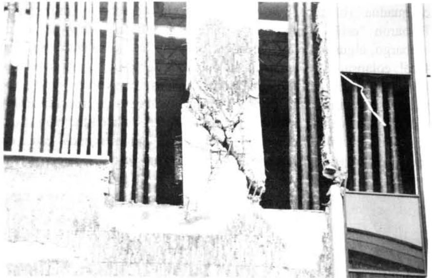
Foto 11 Falla de columna por falta de confinamiento (Cardona)
