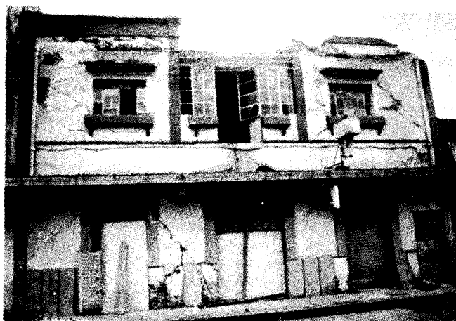
Fig 29 Falla en muros de carga por falta de confinamiento adecuado.
