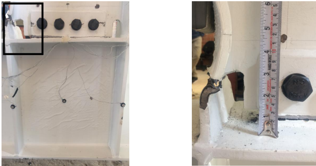
a) Daño en panel y falla en soldadura b) Acercamiento en la fractura del patín
