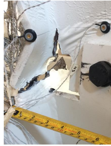
b) Acercamiento en la fractura del patín
