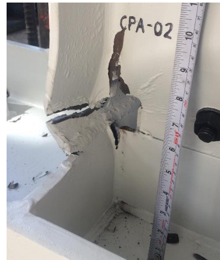
b) Fractura del patín
