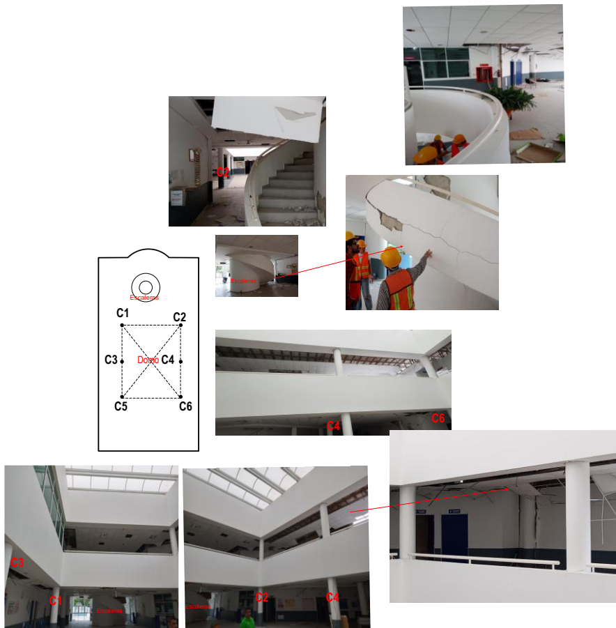
Figura 27. Daños observables en la zona central del edificio principal.
