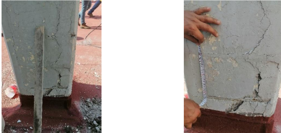
Figura 33. Distribución de estribos uniforme con la altura a cada 20 cm, armado expuesto.
