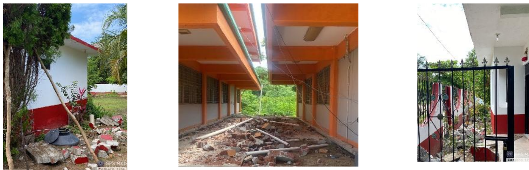
Figura 17. Caída de elementos no estructurales durante el evento sísmico
