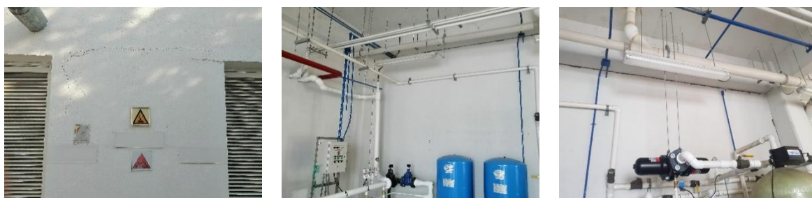
Figura 32. Daño ligero en los muros no estructurales del cuarto de máquinas (Hospital Regional de Apatzingán)
