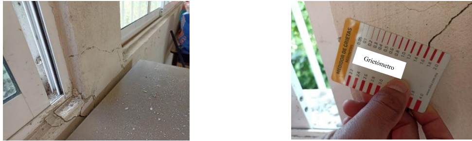
Figura 14. Daños en columnas cortas debidos a la presencia de muros que restringen su desplazamiento
