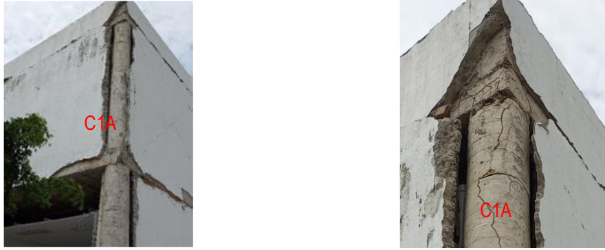
Figura 26. Daño en la columna C1A, en la fachada principal.
