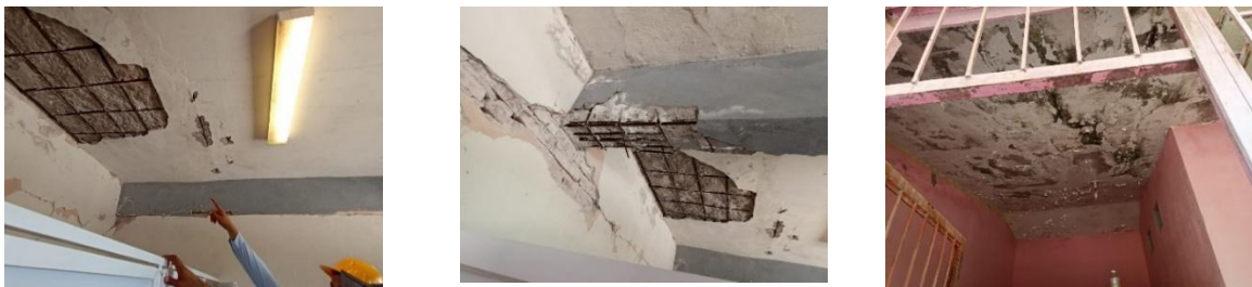
Figura 20. Problemas de humedad y corrosión en elementos de concreto reforzado por falta de un mantenimiento adecuado
