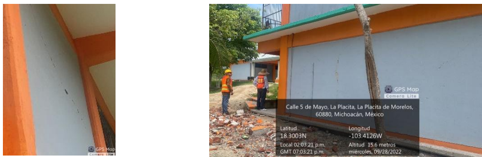
Figura 16. Agrietamiento diagonal en muros diafragma de mampostería
