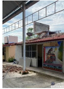
b) Caída de apéndices (tanque de agua)
