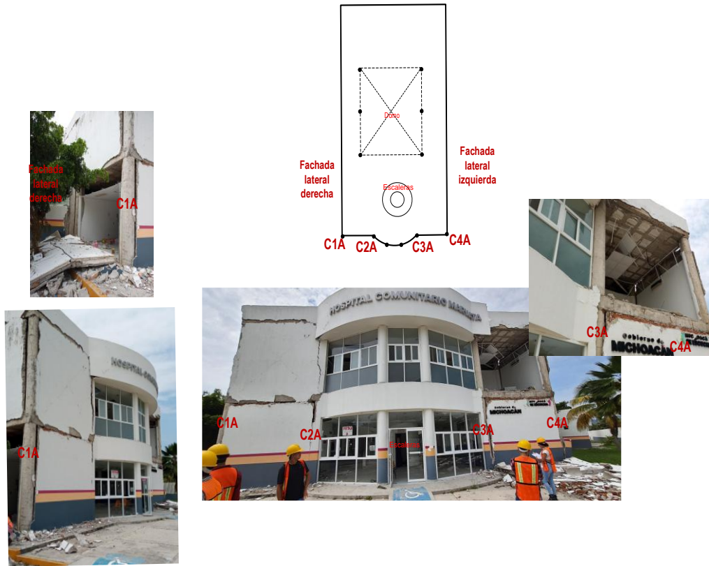
Figura 24. Daños estructurales en la fachada principal del Hospital Comunitario de Maruata
