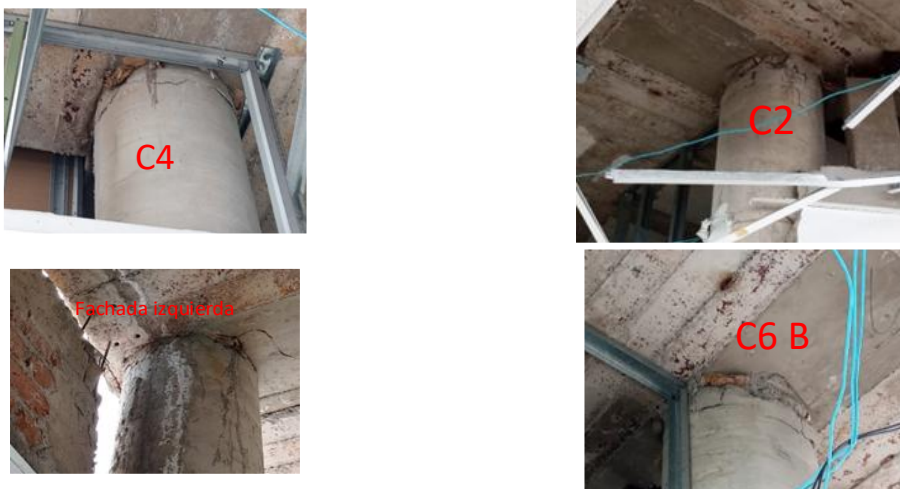
Figura 25. Daño por aplastamiento en la cabeza superior de las columnas el Nivel 2.
