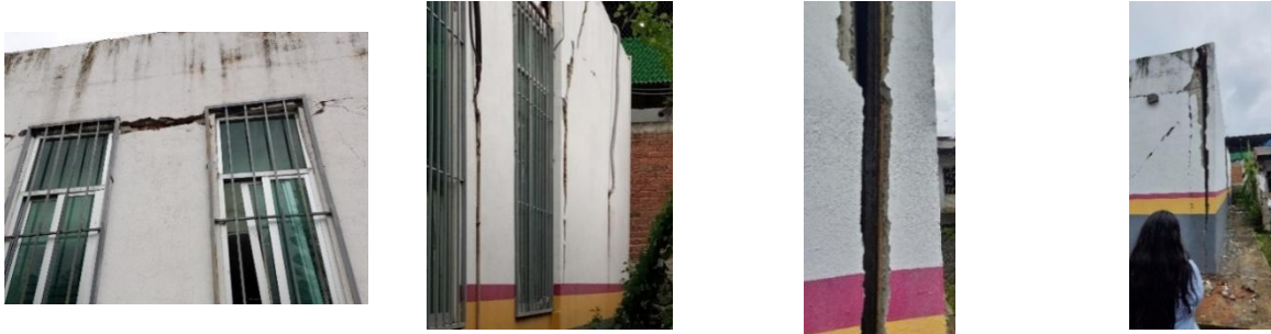
Figura 22. Daño en los muros de mampostería de la fachada del Centro de Salud de Aquila
