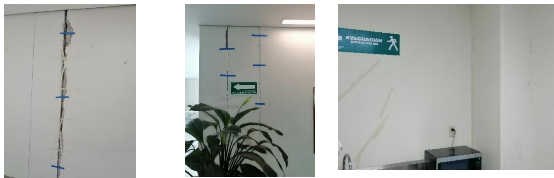
Figura 31. Separación vertical entre muros y columna en el Hospital Regional de Apatzingán
