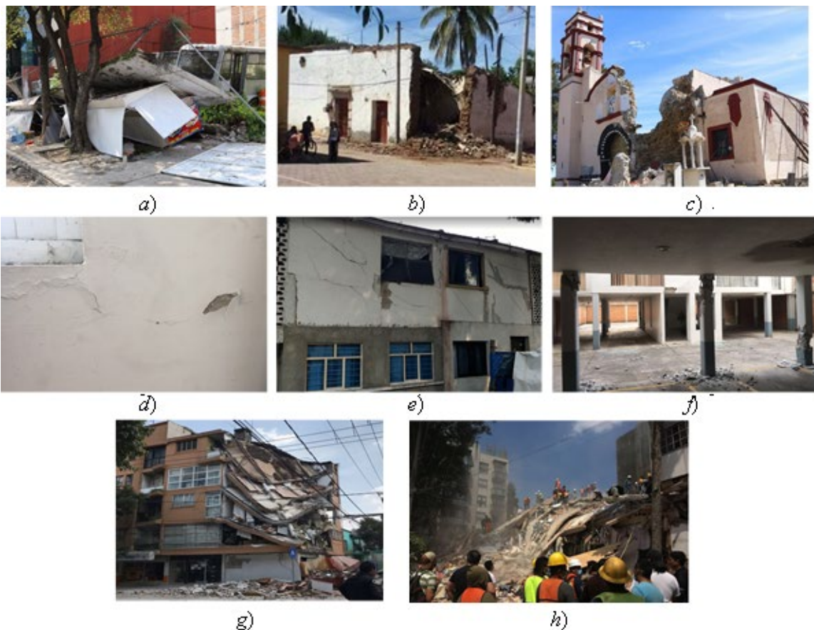
Figura 8. Algunos ejemplos de estructuras dañadas en el sismo de septiembre de 2017 acorde a la tabla 1: a) daño en bardas, b) estructuras débiles y sin ingeniería, c) estructuras antiguas, d) grietas en acabados y elementos no estructurales, e) grietas pequeñas en muros, traveses o columnas, f) grietas importantes en muros, traveses o columnas, g) colapso de pisos superiores y h) colapso
