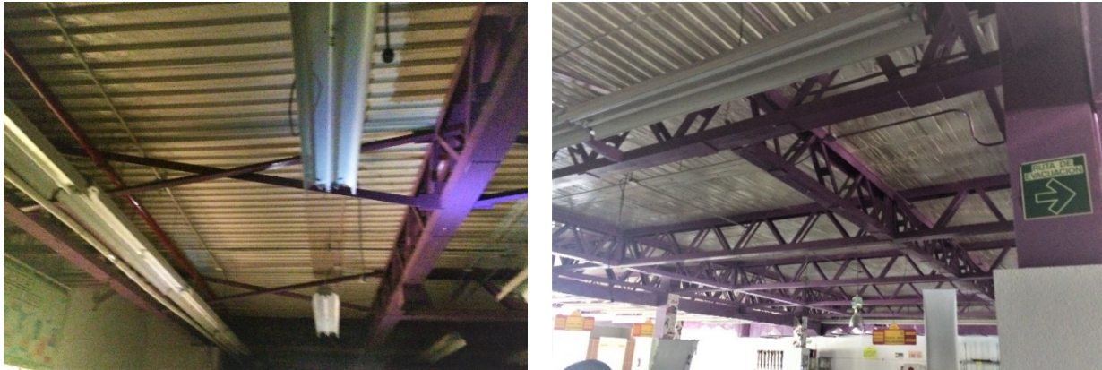
a) Detalle de arriostramientos laterales b) Vista de traves principales y secundarias Figura 9. Detalles de las armaduras planas
