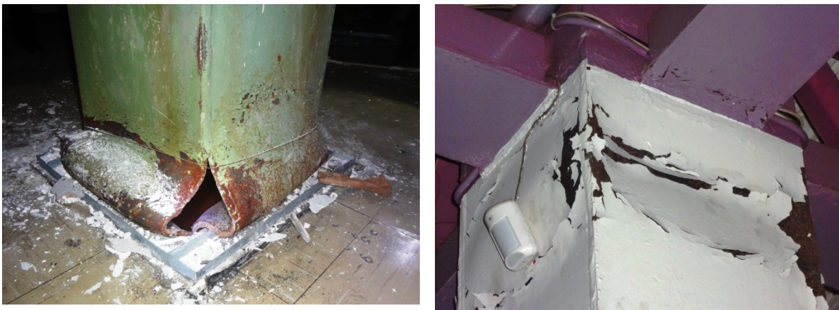
Figura 4. Ejemplo de daño registrado en las columnas de planta baja
