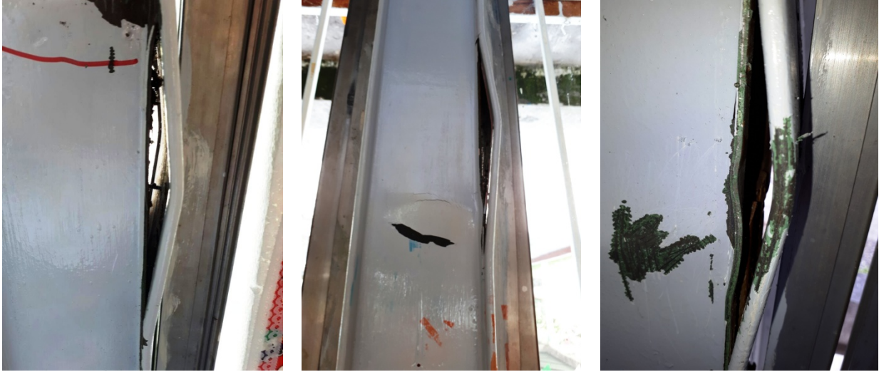
Figura 14. Daño en la soldadura corrida y pandeo local típico en las columnas
