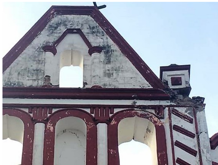
Figura 3. Agrietamientos en la parte alta de la fachada
