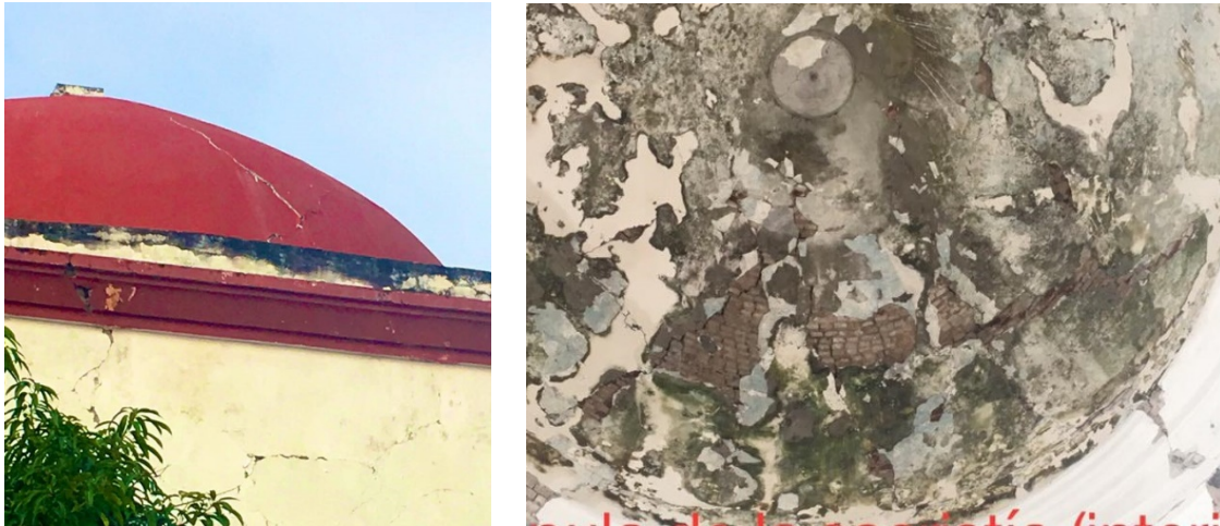
Figura 2. Daños en cúpulas
